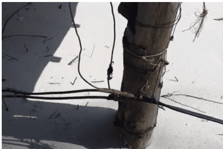
Gambar 2 Instalasi Listrik Penginapan di Desa Wisata Pulau Mubud Darat
